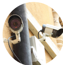
Backhaul de Videovigilancia
